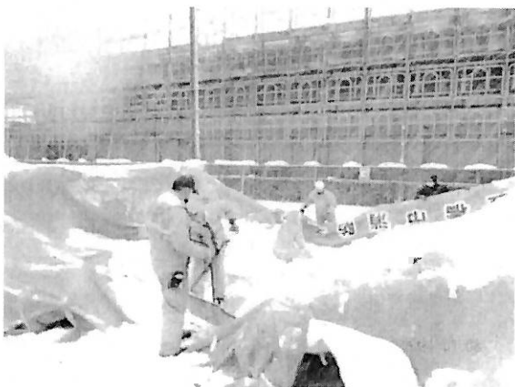
宿営状況（雪により座屈）
